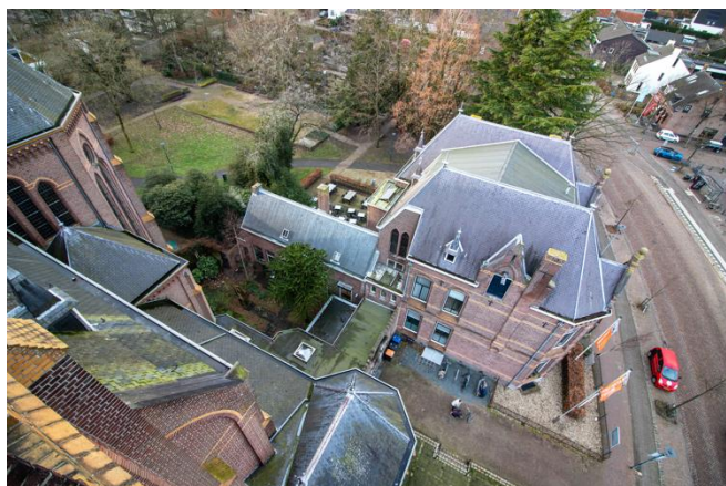
De pastorie(Uitdaging) en de kerk tellen heel veel leitjes. Een leitje vervangen is niet zo moeilijk. Wel om erbij te komen.
